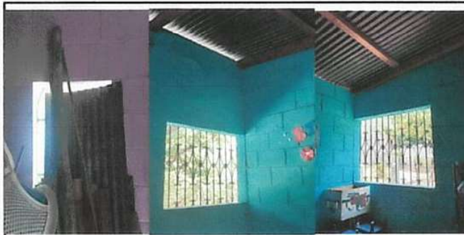
Foto 3: EL ESTABLECIMIENTO NO CUENTA CON VENTANAS EN EL AULA NI EN LA COCINA Y SON NECESARIAS PARA PROTEGER DEL INGRESO DE ANIMALES
