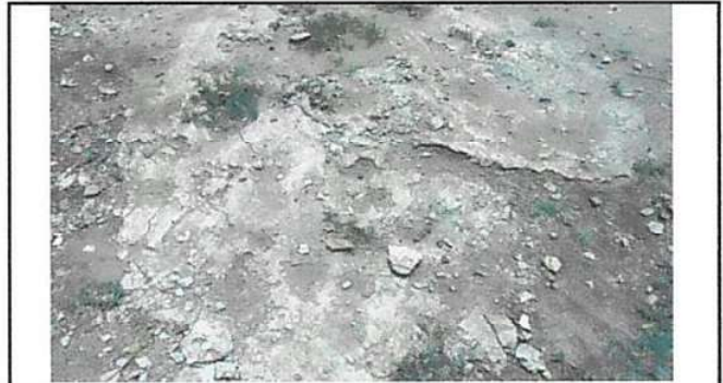
Foto 4: EXISTE LA NECESIDAD DE COLOCAR PISO DE TORTA DE CONCRETO YA QUE AL LLOVER SE FORMA LODO EN EL PISO DEL PATIO.
