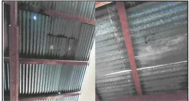
Foto 2: EL TECHO DE LA ESCUELA TIENE LÁMNA ACANALADA EN MAL ESTADO Y SU ESTRUCTURA ES DE MADERA QUE YA PRESENTA DEFICIENCIAS
