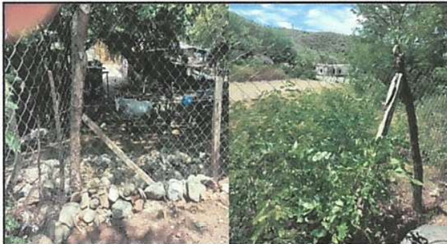
Foto 1: ES NECESARIA LA CIRCULACIÓN CON MALLA CON BASE DE BLOCK Y POSTES DE METAL EN TODO EL PERÍMETRO PARA EVITAR INGRESO DE PERSONAS AJENAS Y ANIMALES
